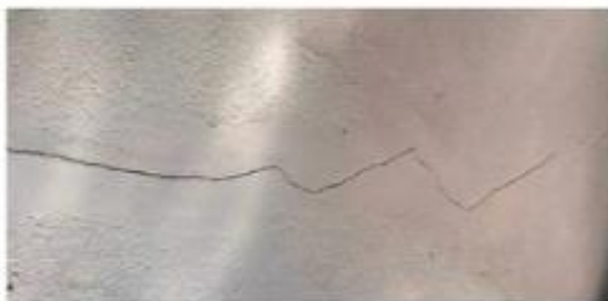
A parede da casa de um morador do município ficou rachada
